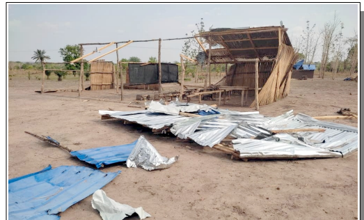
Die provisorischen Klassenzimmer der Primarschule in Konigbo in Togo wurden bei einem Gewittersturm zerstört. Die Einnahmen aus den Afrikatagen am 15./16. Juli 2023 in Böbingen an der Rems kommen der Schule zugute.
